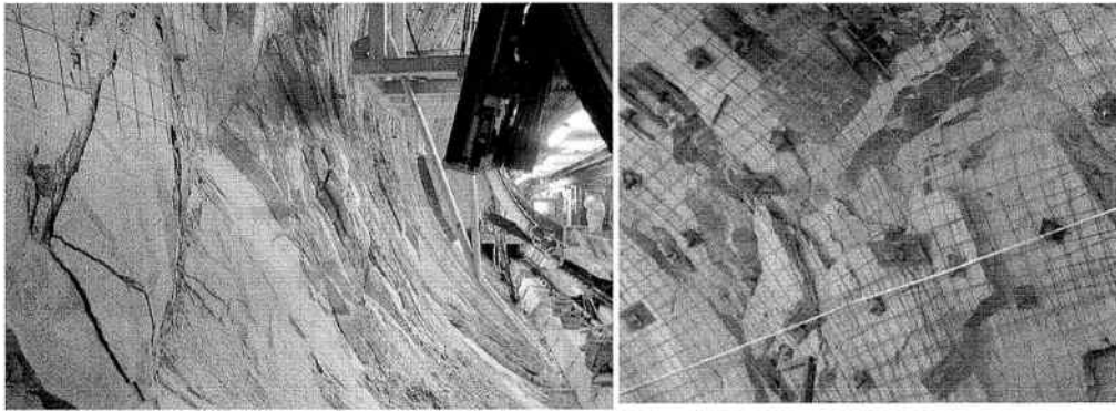
Şekil 34. Lötschberg Tüneli kaya patlaması problemleri: (a) kavlaklanma, (b) kaya fırlaması (Vuillemeur vd., 1997).
