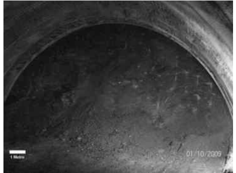
Şekil 5. 34 nolu tünel çıkış aynası (KM: 231+038,35-KM:231+037,30).
