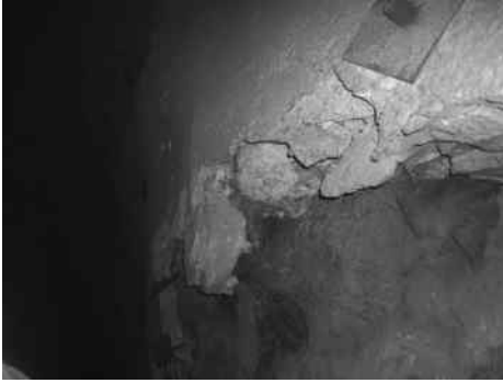
Şekil 4. Kırılmış beton tahkimat.
