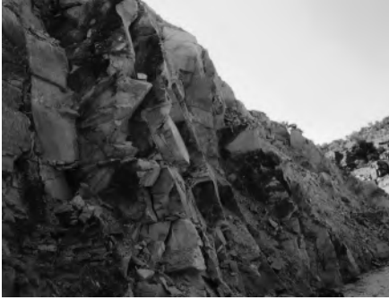
Şekil 7. Yüksek açılı şev kazısı sonucu duraysızlaşan kama kütlesi kayma yüzeylerinin görünümü.
