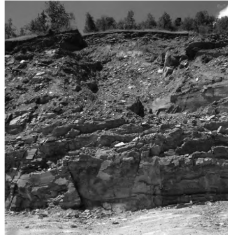
Şekil 6. Gölet alanı sağ sahil yamacındaki A1 ve A2 çatlak takımlarının oluşturduğu kama bloklarının görünümü.
