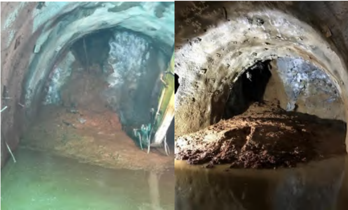
Şekil 3. Kaynarca-Sabiha Gökçen Metro Bağlantısı km 2+682'de Dolayoba Kireçtaşı'nda karşılaşılan karst ceplerinden malzeme ve çamur akmaları.
