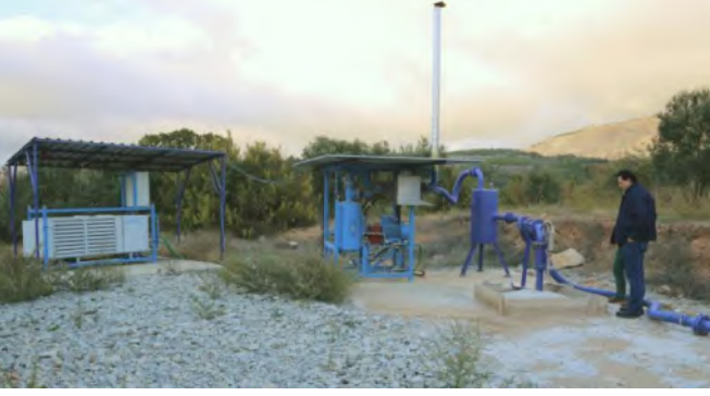
Şekil 8. A Panosu üzerindeki metan drenaj sondajı ve tesisi.
