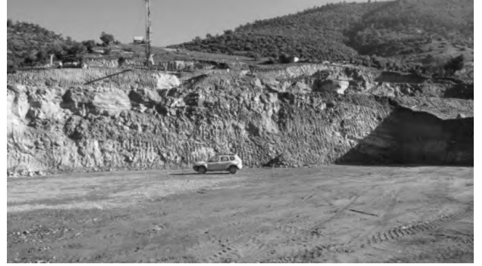
Şekil 4 Dökülmelerin olduğu C şevi
