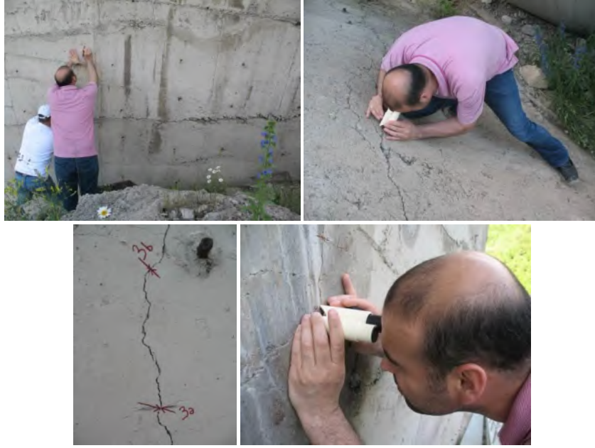
Şekil 2. Cebri boru su alma yapısı duvarında ve eğimli beton platform üzerin çatlak ölçümleri
