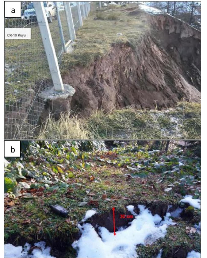
Şekil 1. CK 10 Sondaj lokasyonu görünümü (a), şev tepesindeki çekme çatlaklarının görünümü (b)
