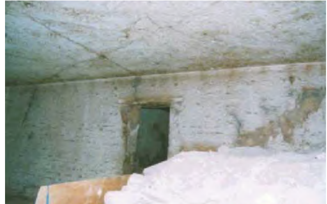
Şekil 14 J odası ile bitişik Jd ve Je odaları arasındaki duvardaki çatlakların görünümü
