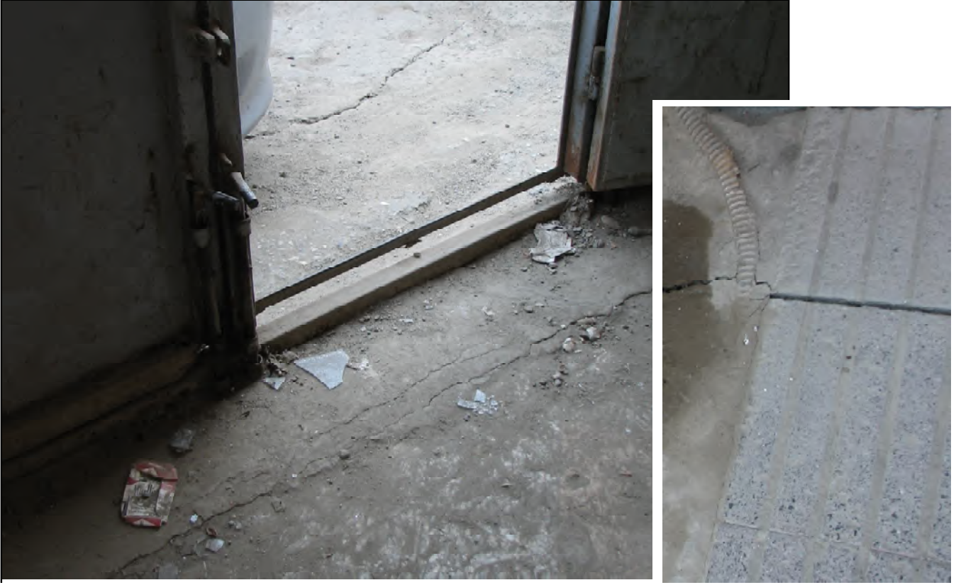
Şekil 8. Kuzey konkorsu batı duvarına paralel dükkan döşemesinde ve kaldırımda oluşan açılmalar
