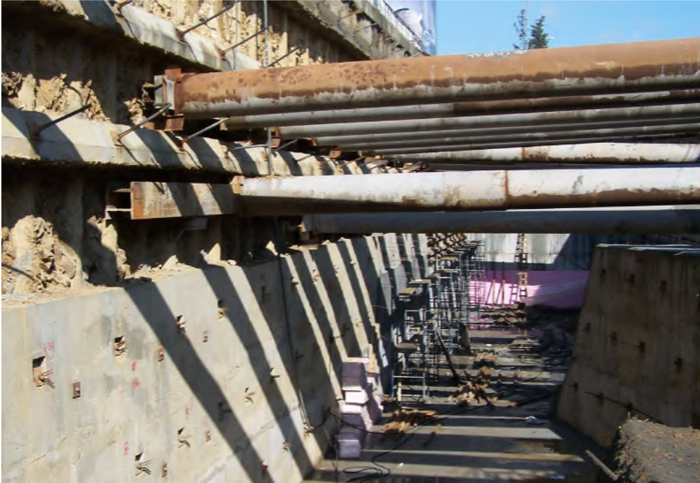
Şekil 9. Aşırı deformasyonların olduğu batı duvarı destekleme sistemine ilave edilen çift sıra yatay borular.
